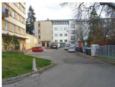
Degradované povrchy na parcelách p. č. 16/3 a 10/2
